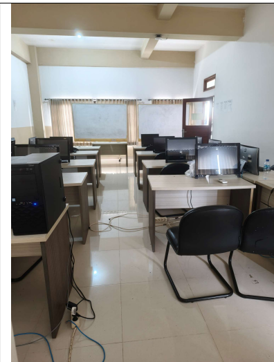
Kondisi kelistrikan laboratorium
