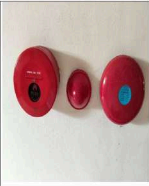
Alarm Kebakaran diluar ruang kelas lantai 4 gedung ARL
