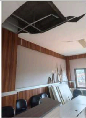
Kondisi kerusakan ruang penerimaan di aula 2
