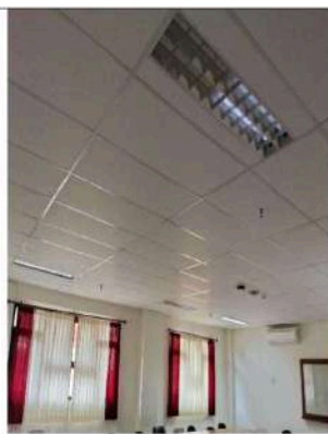
Kondisi lampu di ruang kelas ARL 1.11
