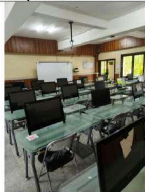
Kondisi pencahayaan dan kelistrikan di laboratorium
